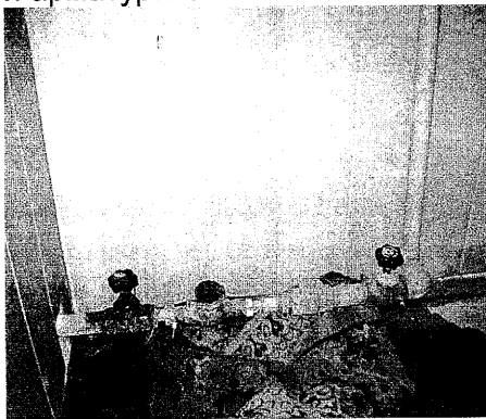
Сграден водомерно-арматурен възел
