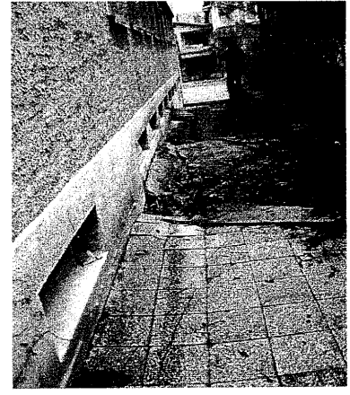
Деформиран плочник от южната страна на сградата
